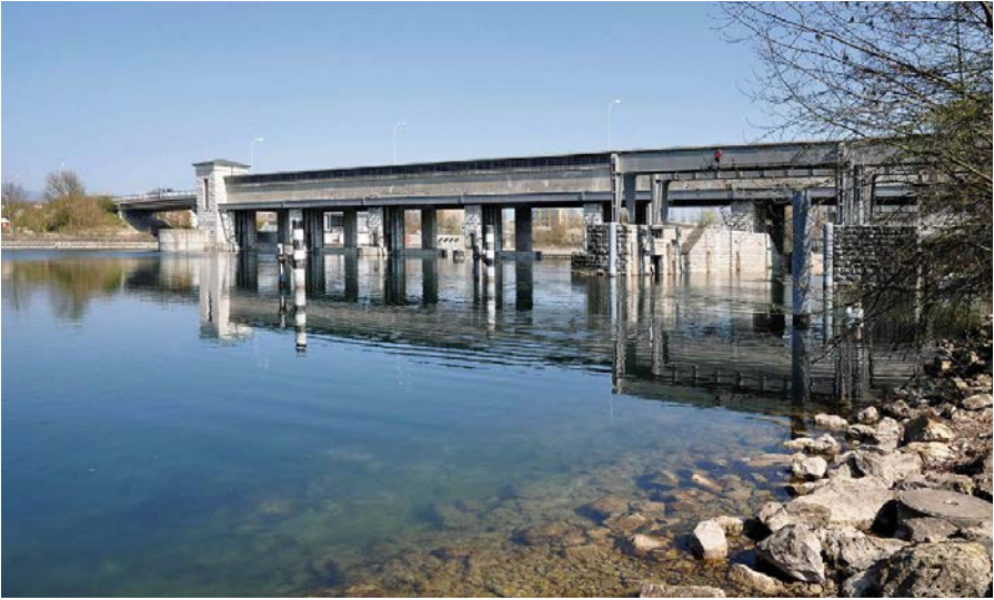
Stauwehr und Kraftwerk Port: Das Stauwehr ist das Herzstück der Juragewässerkorrektur. Mit dem Wehr lassen sich sowohl die drei Juraseen bewirtschaften als auch der unterliegende Lauf der Aare bis zum Wasserschloss bei Brugg-Windisch.
