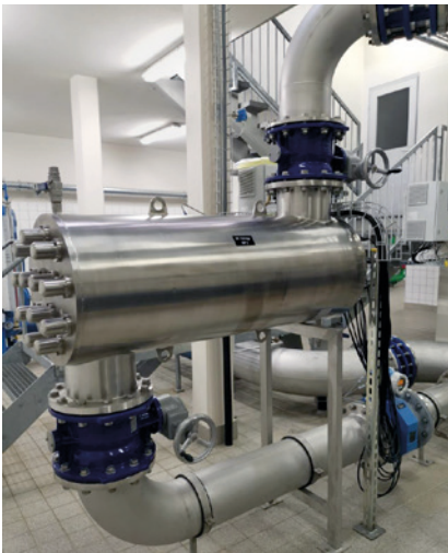
UV-Anlage im Pumpwerk Schachen
