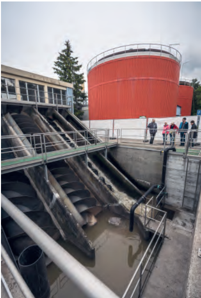
Einlaufpumpwerk mit 4 Schneckenpumpen
