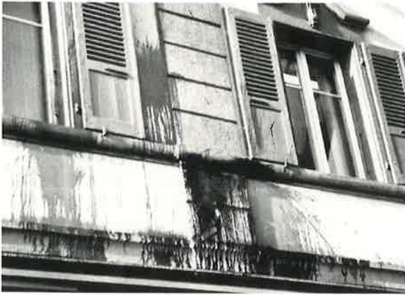
Rote Farbe aus Farb- beuteln beschädigte die Fassade des Gemeindehauses schwer und erforderte kostspielige Restaura- tionsarbeiten
